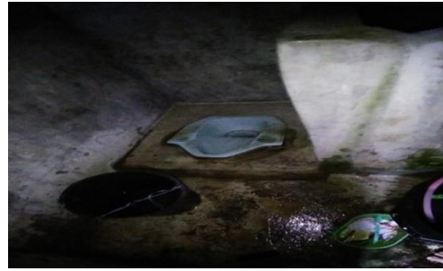
9. Wc yang kurang dibersihkan
